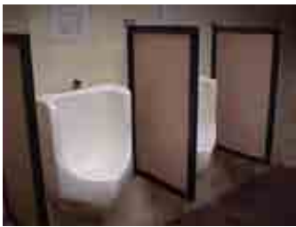
Instalaciones del IMTA. Mingitorios ecológicos
