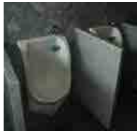
Edificio sede de SEMARNAT. Mingitorios ecológicos
