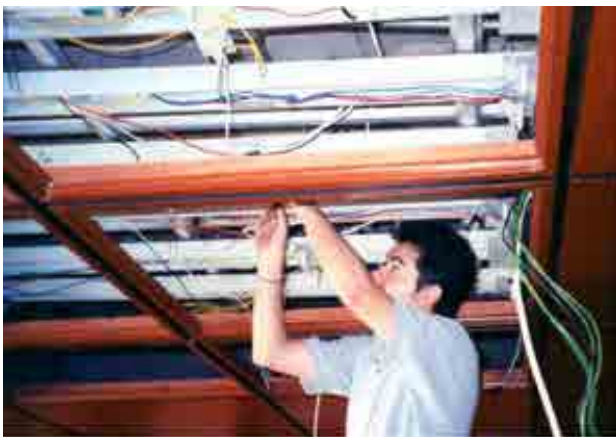
Instalación de sistema inteligente en las oficinas del Secretariado de Medio Ambiente y Recursos Naturales.
